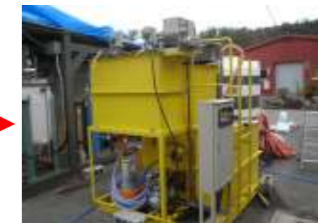
濁水処理プラントの例
