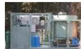
濁水処理プラント (30m 3 /h処理)
