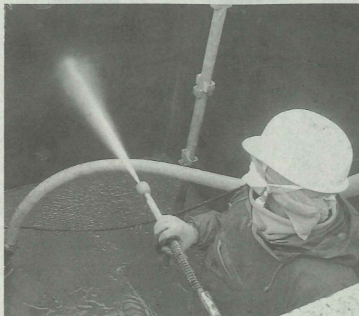
汚染された壁などを洗い流した後の水処理などにネオナイトの除染剤が使われている
